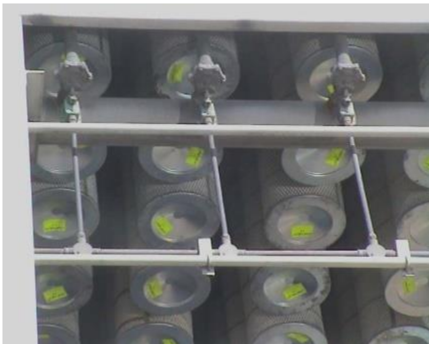
تصویر (۴-۱) بخشی از سیستم تمیزکاری فیلترها
