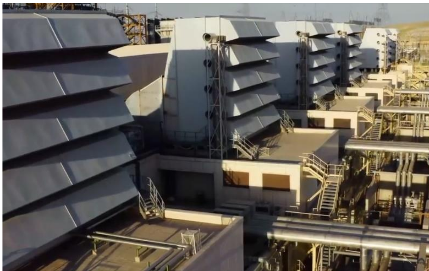
تصویر (۱-۱) سیستم ورودی هوا
